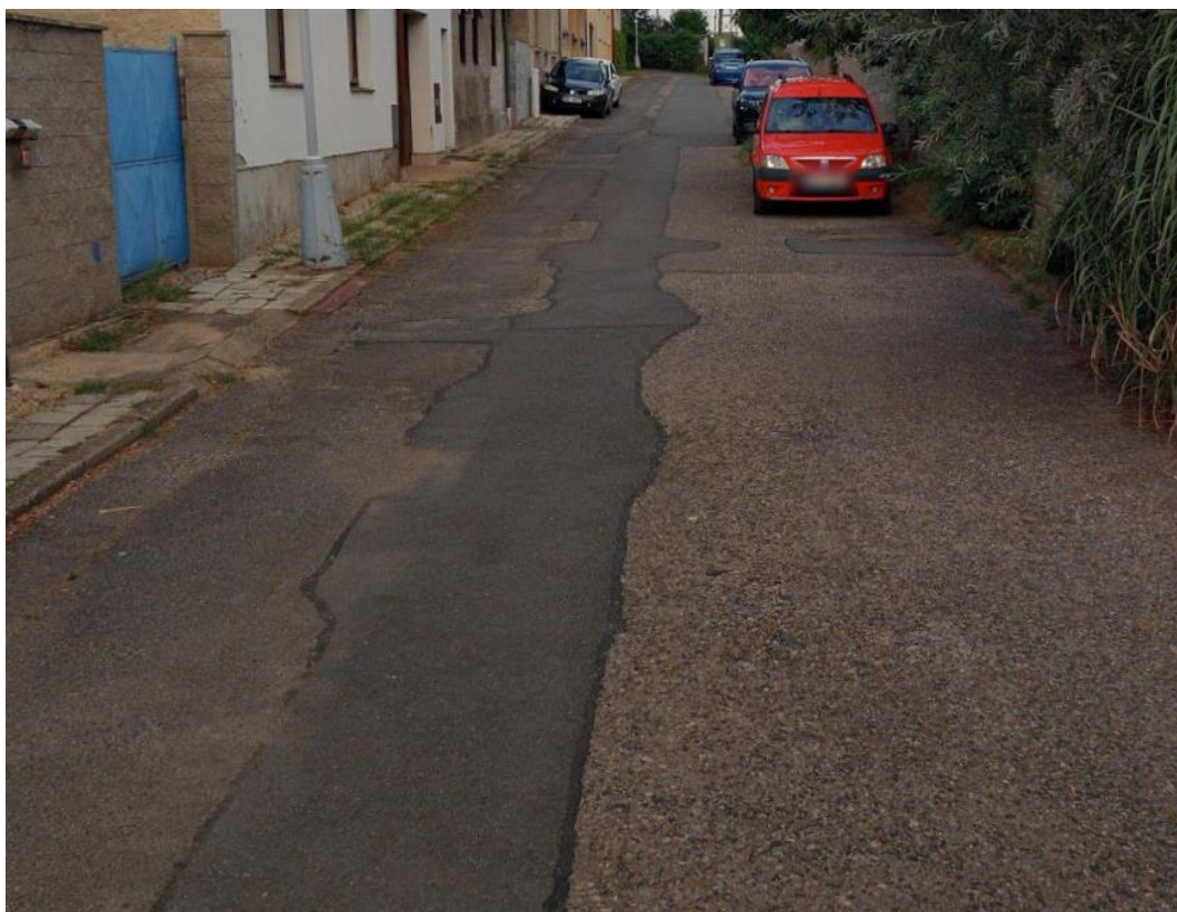
Místní komunikace v severovýchodní části obce vyžadující úpravu povrchu.
